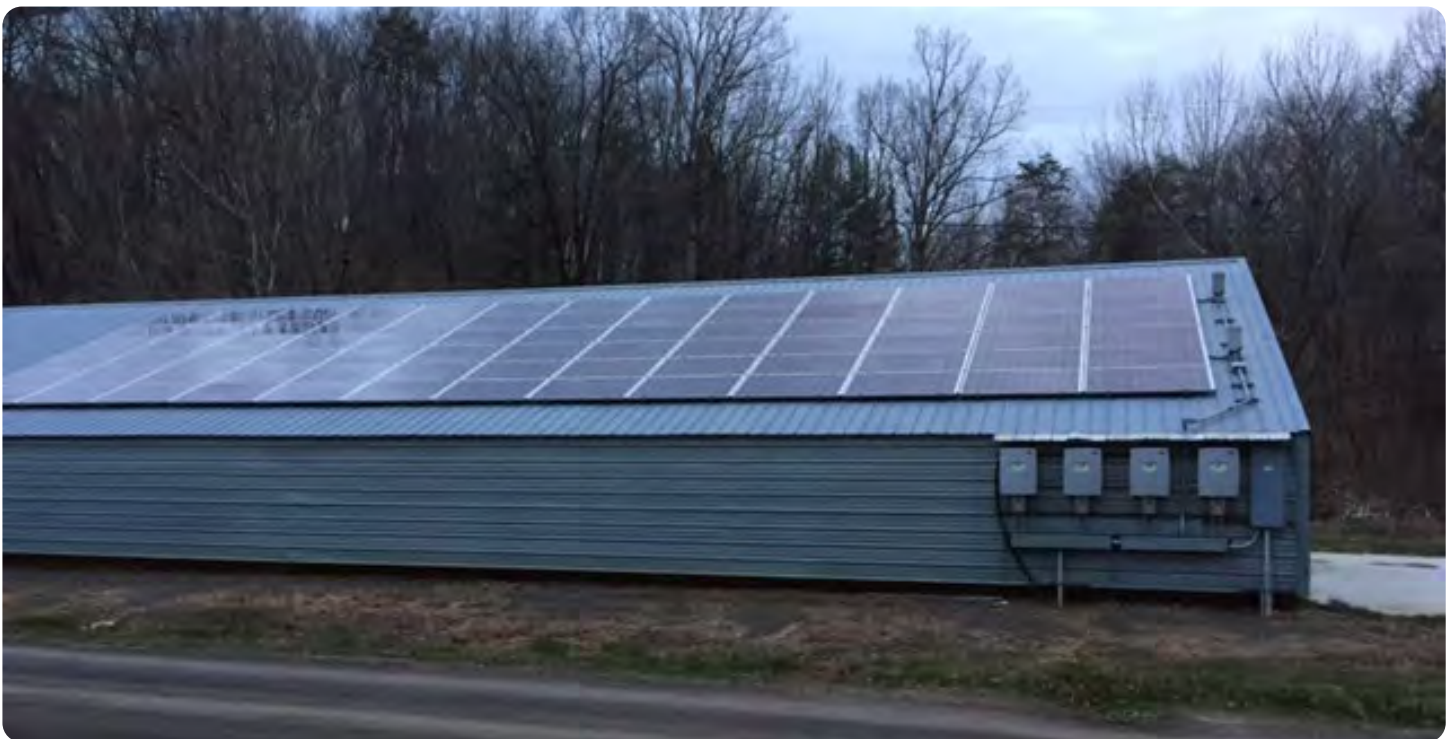
Paneles solares proveen energía al gallinero de Ward Malcolm en West Virginia.
